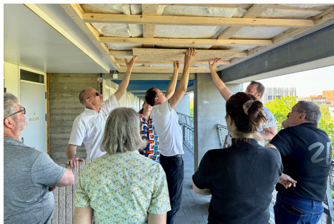
Styregruppen beser prøveudførelsen af den nye indretning af altangangene sammen med arkitekten og ingeniørrådgiveren.
